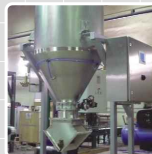
Станция дозирования сырья
